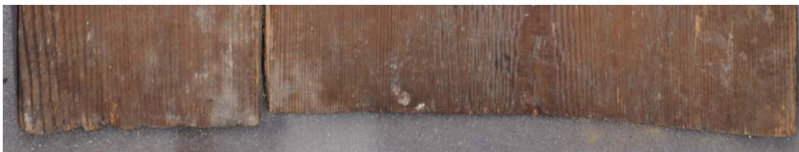
Detalii față și verso care pun în evidență degradările icoanei
