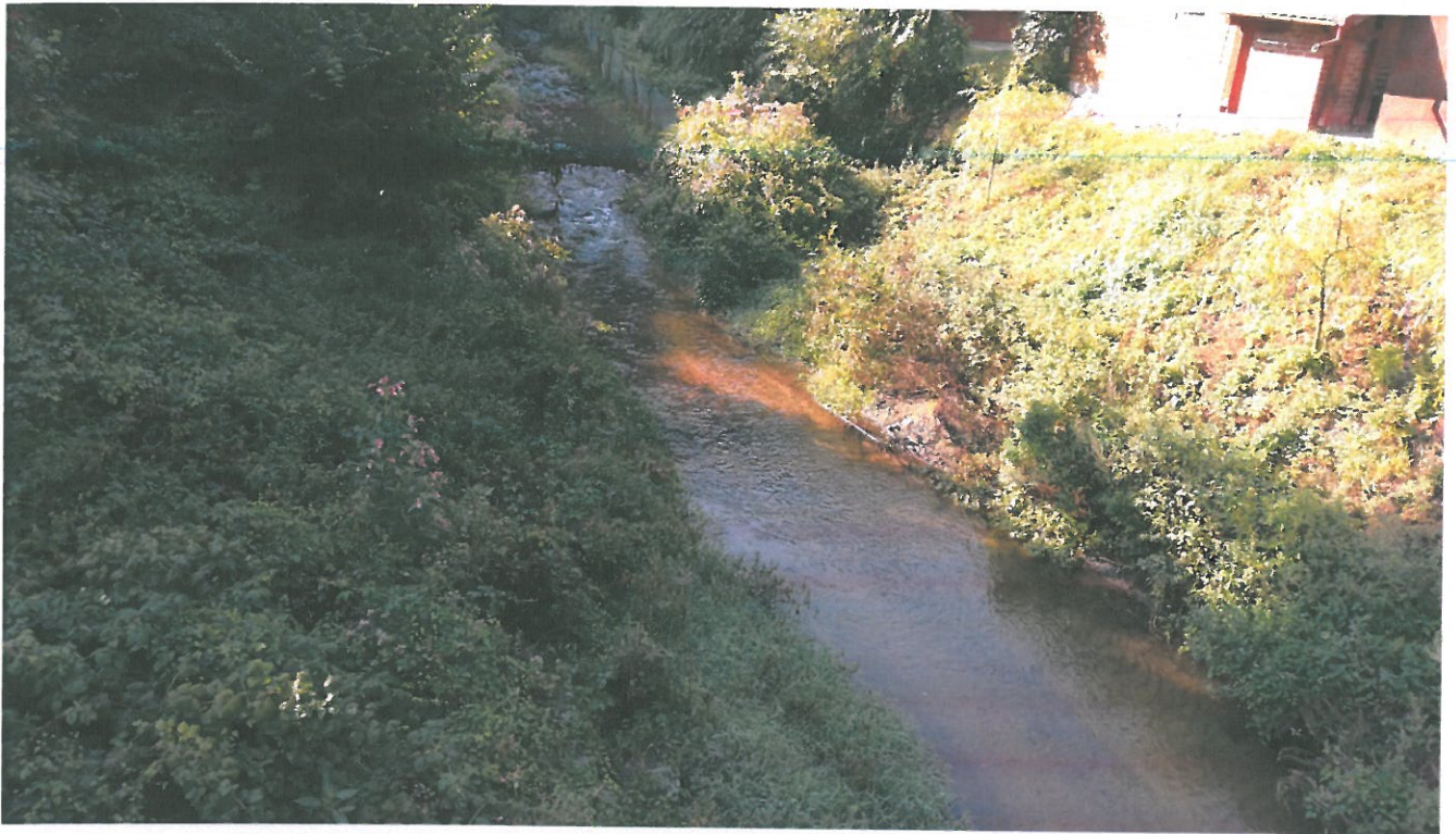
Foto 3: Vedere amonte pod- Albie colmatata, depuneri de material solid, vegetatie
