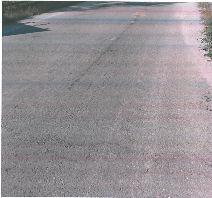
Foto 9: Degradari ale caii de rulare - vegetatie pe cale, in zona trotuarelor si langa parapeti
