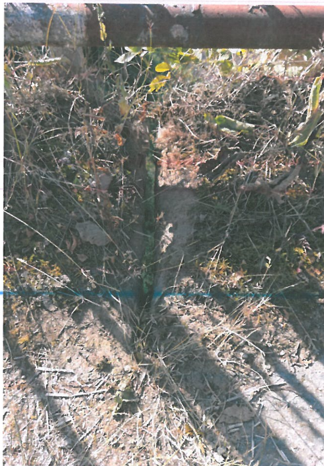
Foto 12: Degradarea imbracamintei asfaltice pe trotuar, ruperea grinzii parapet
