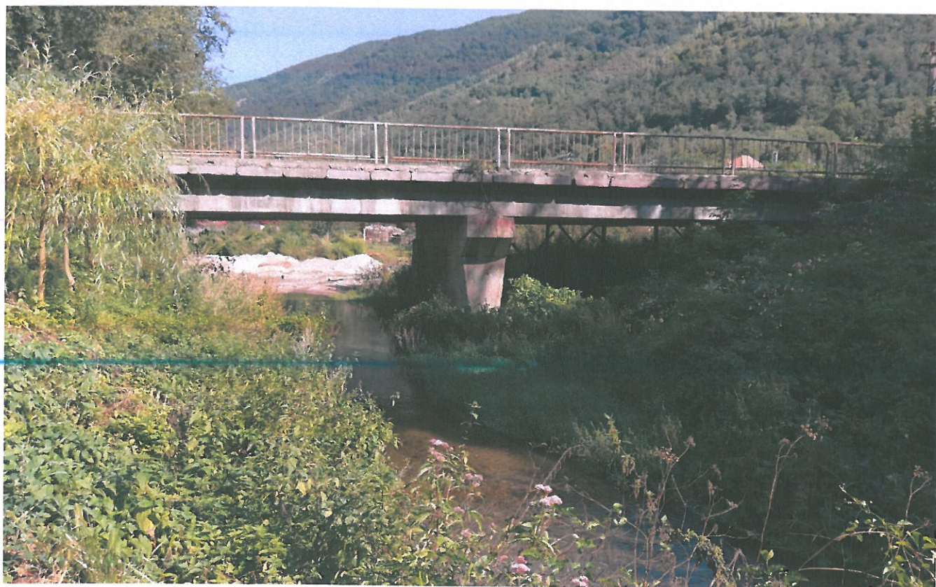
Foto 6: Vedere dinspre amonte: se observa structura de sustinere elemente prefabricate de trotuar, colmatari, vegetatie abundenta
