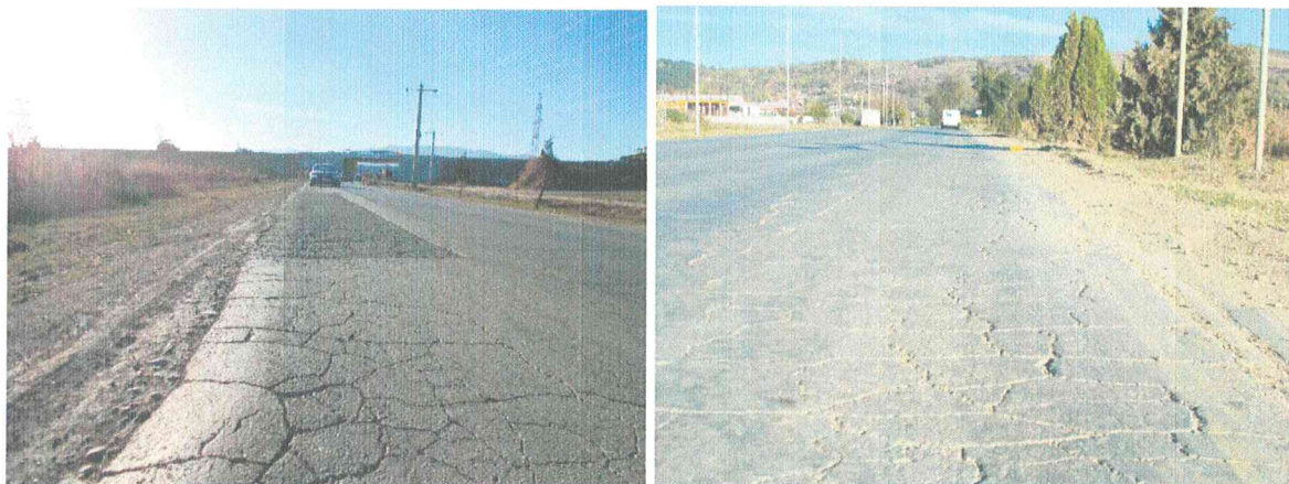
Sectoare de drum cu defecțiuni ale structurii rutiere-faianțări în plăci
