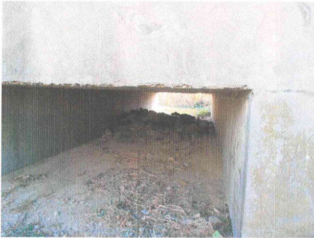
Podet dalat colmatat fără amenajare amonte și aval
