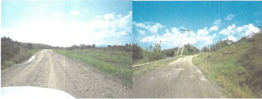
Sectoare drum cu lipsa dispozitive de colectare ape pluviale
