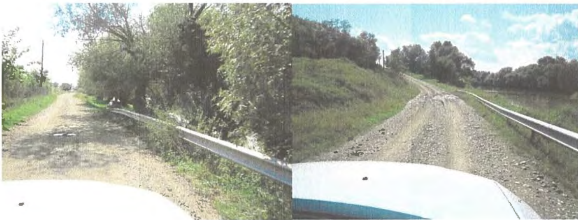
Sector de drum cu parpaet flexibil degradat
