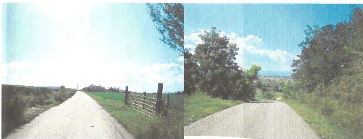
Sectoare de drum cu defecțiuni ale îmbrăcămintei rutiere/ structurii rutiere
