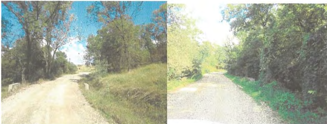
Podete tubulare colmatate si acoperite de vegetatie
