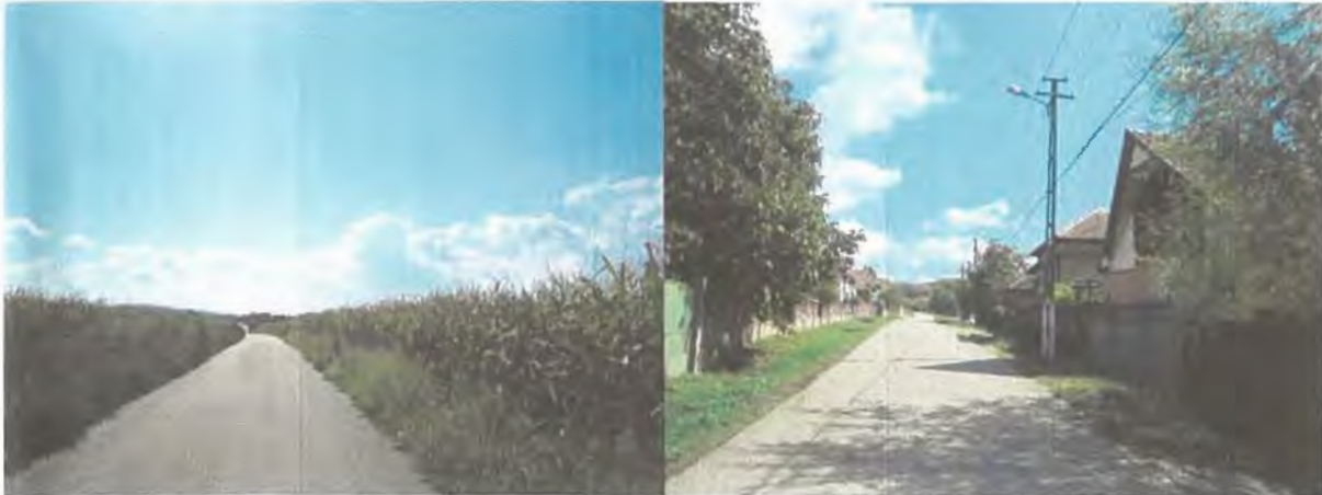
Sectoare de drum cu vegetație abundentă care împiedică scurgerea și evacuarea apelor pluviale
