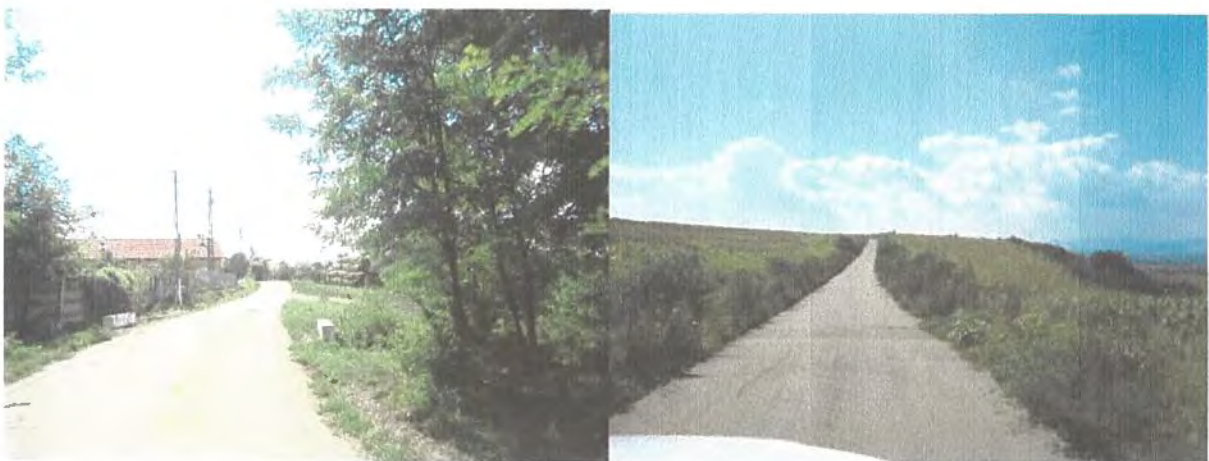
Sectoare de drum cu podețe colmatate
