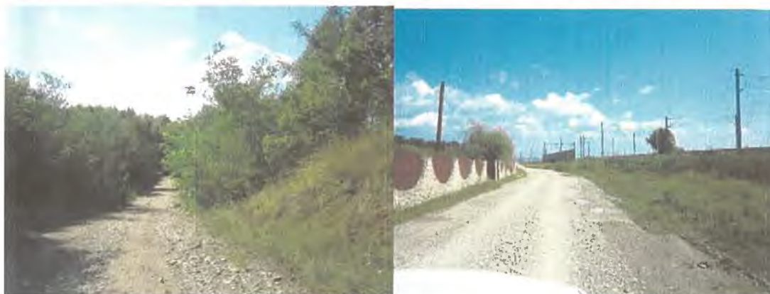
Defecțiuni ale drumurilor pietruite-făgașe și gropi
